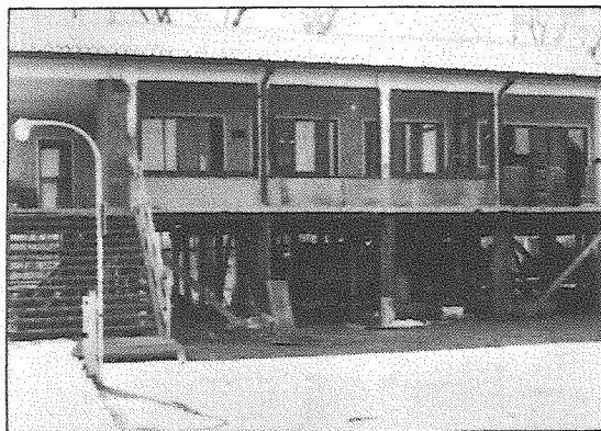
Esta foto muestra la ampliación del edificio con el cierre de parte de la galería delantera que redundará en beneficio del socio y su familia brindándole comodidad y confort.
